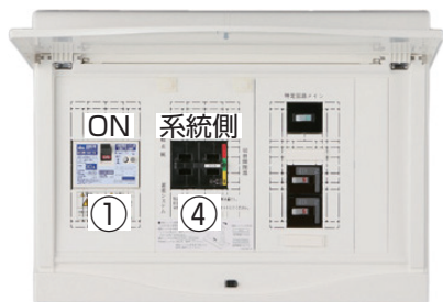
蓄電システム用分電盤
